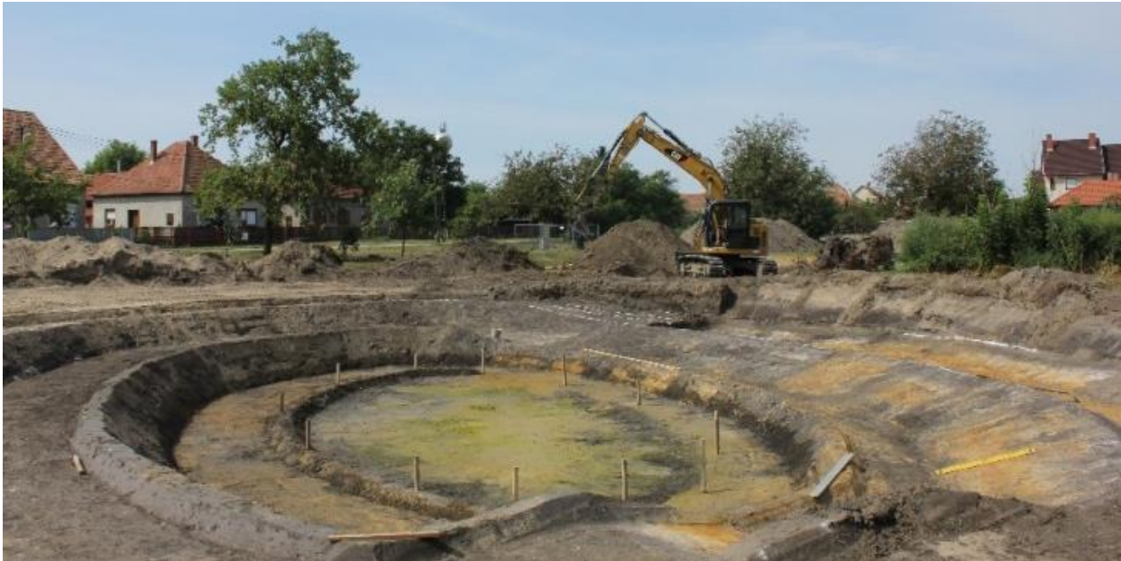
Figura 46 - Crearea unei geometrii diverse și neregulate a albiei la Ruzsa. Taluzurile plate și terasele cu mai multe niveluri alternează. Crearea acestora necesită mai multă atenție și muncă din partea constructorului și reduce volumul rezervorului în comparație cu cel mai abrupt plan înclinat. Malul plat oferă siguranță și un habitat divers pentru viața acvatică. (Fotografie: Mátyás V. Farkas, WWF HU)
